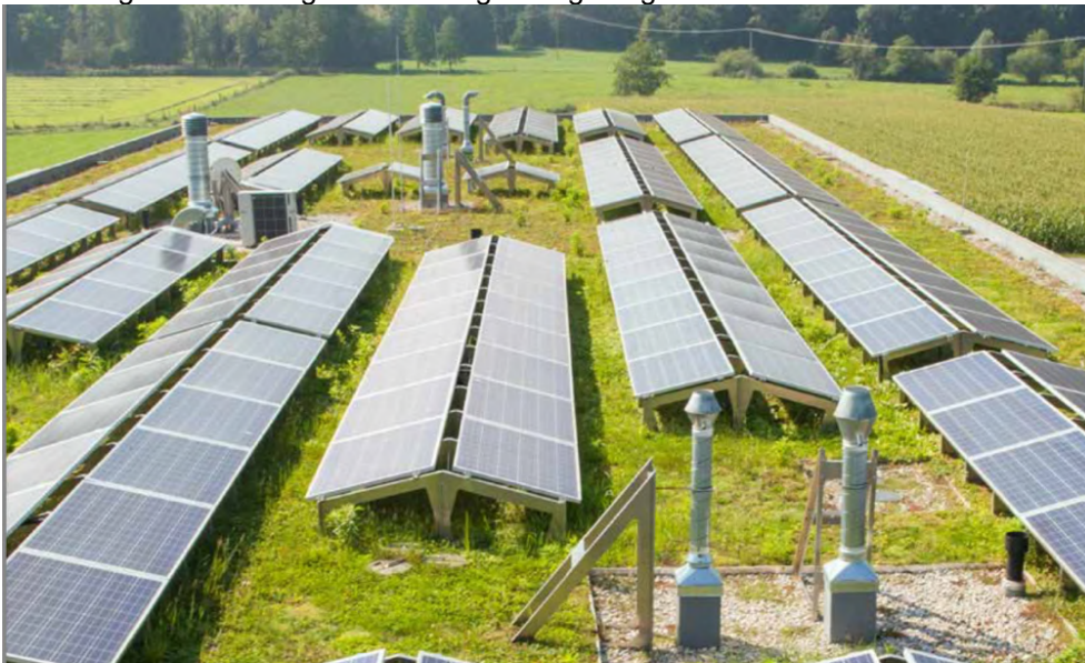
Abbildung 21: PV-Anlage in Dachbegrünung integriert
